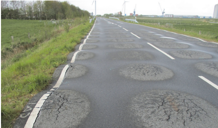
Abbildung 20: Schadensbild im Säulen-Bereich (April 2015)
